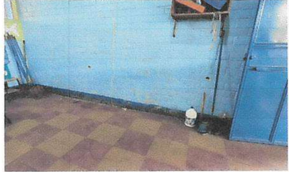
Foto 4: Area donde se esta undiendo el piso por socabamiento.
