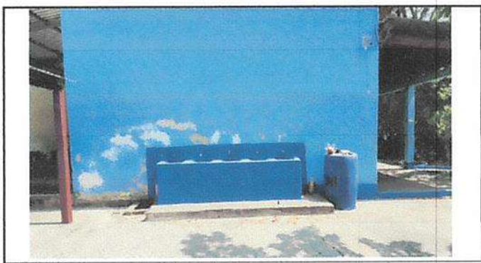
Foto 6: Lavamanos en mal estado.
