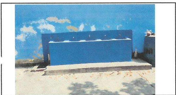
Foto 5: Lavamanos en mal estado.
