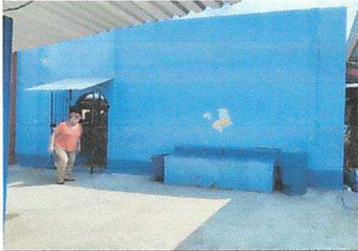
Foto 3: Area de pared en mal estado.
