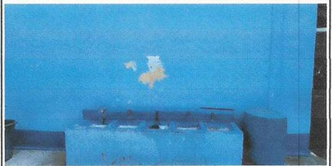
Foto 2: Lavamanos en mal estado.
