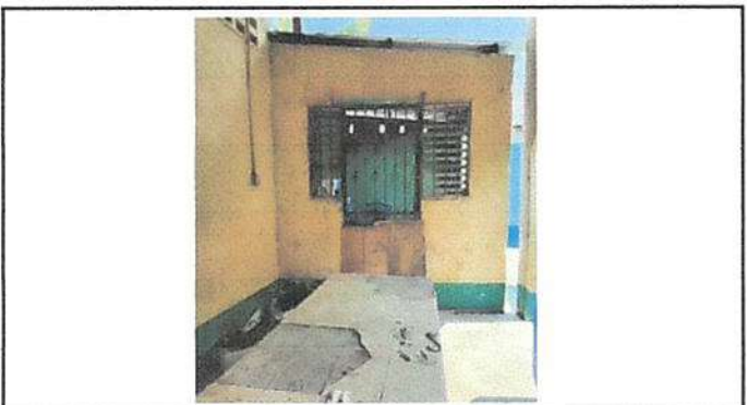
Foto 1: Area de la cocina en mal estado.
